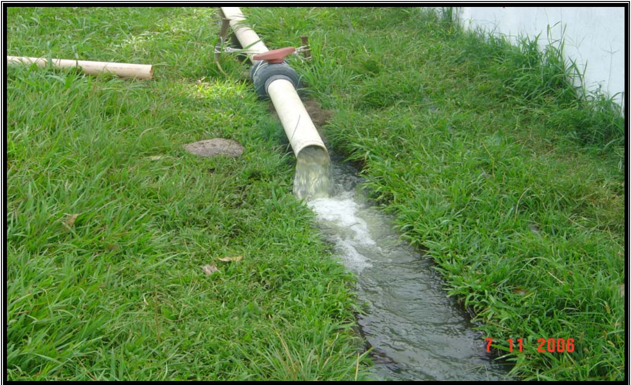
Anexo No. 5 Caudal de agua
