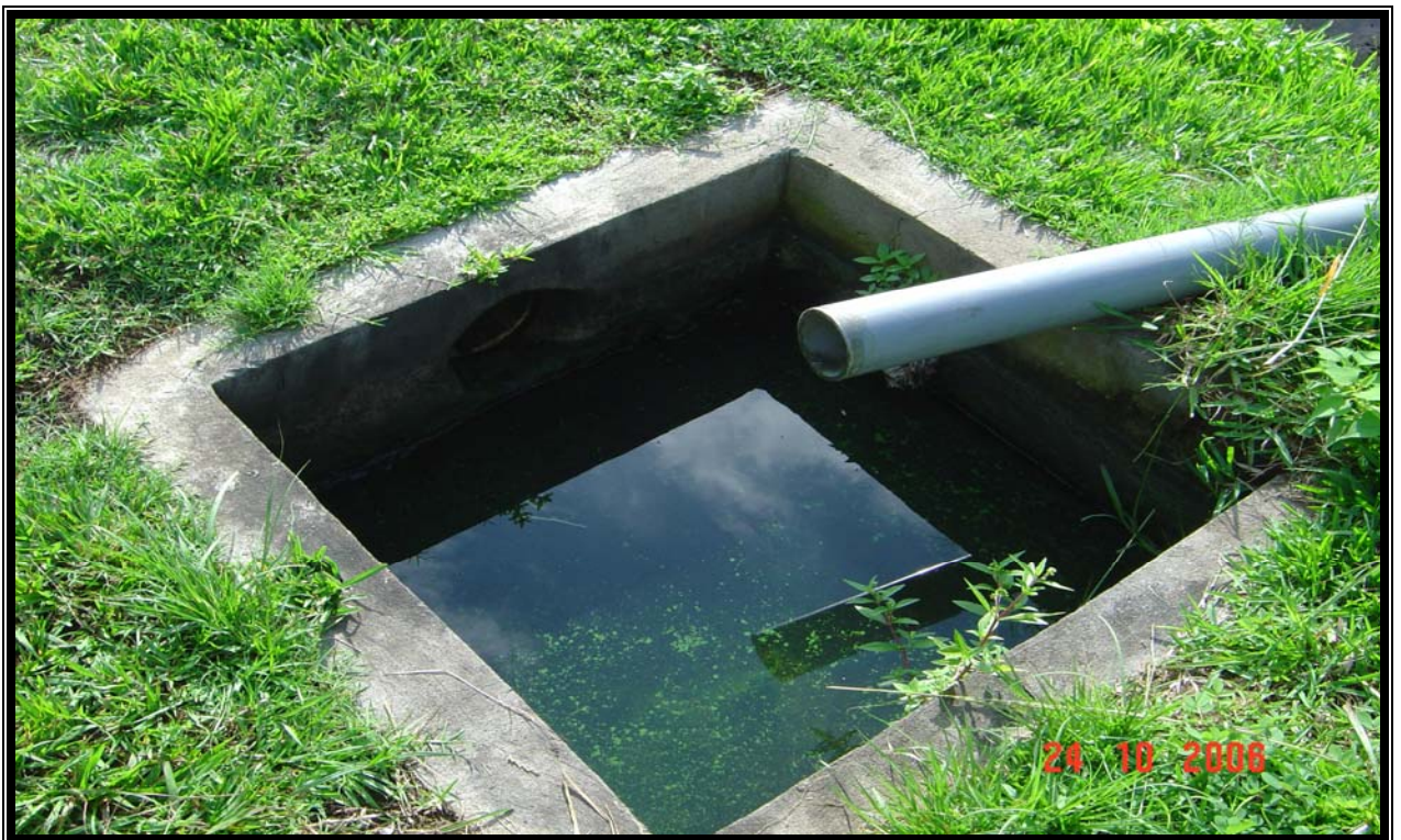
Anexo No. 6 Caja de distribución de agua
