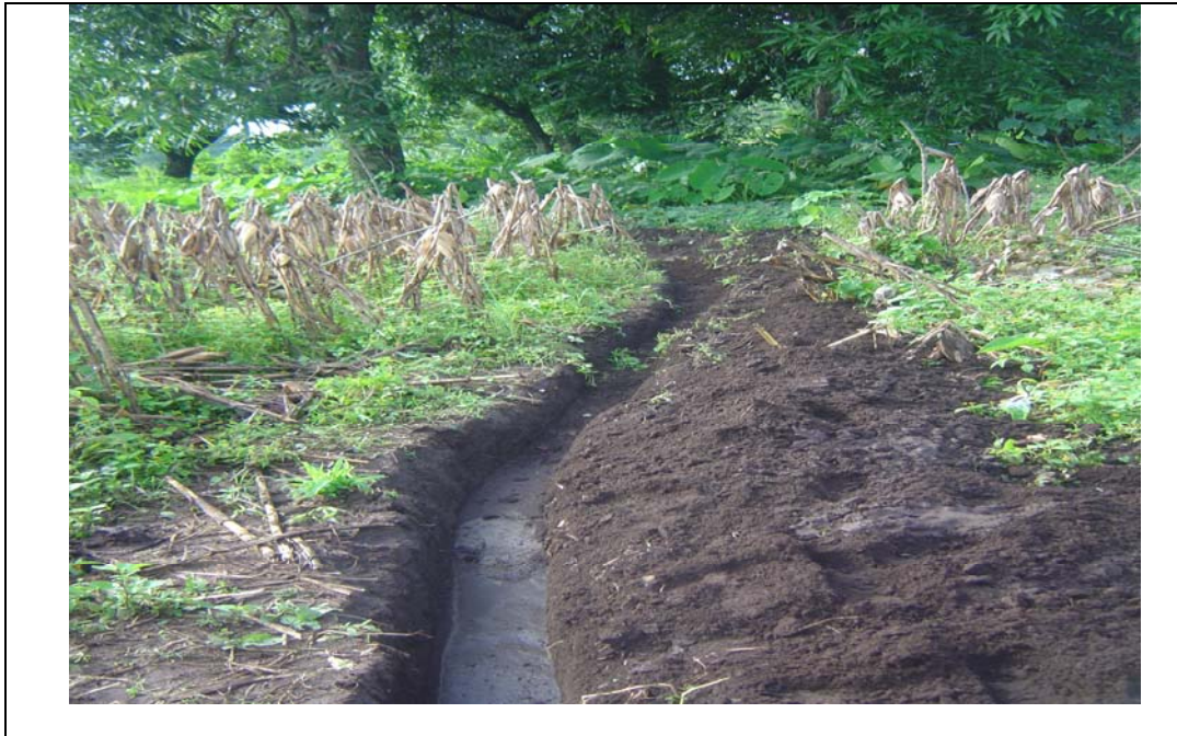
Figura No. 25 Canal para salida del agua
