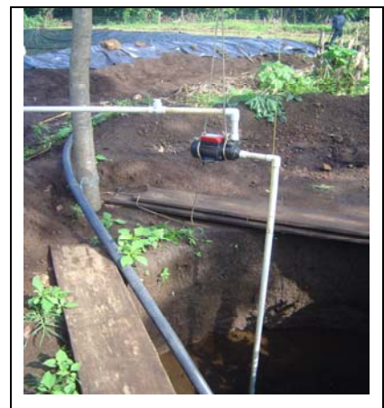
Figura No. 27 Bomba de agua ½ Hp
