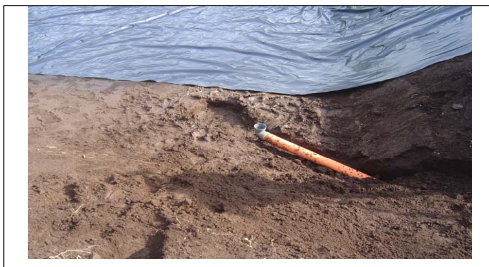
Figura No. 24 Sistema de drenaje en interior de las piscinas
