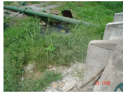
Figura No. 21 Tubo que va hacia el reservorio
