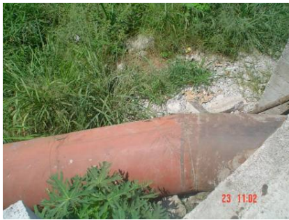
Figura No. 20 Tubo que va hacia la hidroeléctrica
