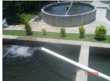
Figura No. 66 Entrada de agua del pozo al reservorio
