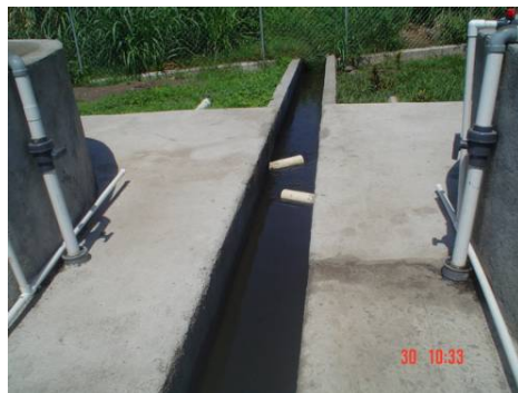
Figura No. 13 Canal de desfogue de los tanques
