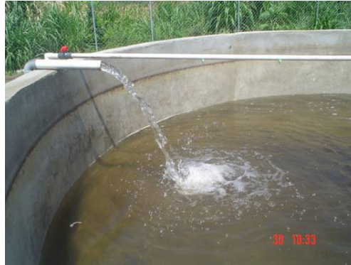
Figura No. 16 Entrada de agua a los tanques
