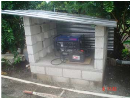
Figura No. 67 Planta de energía eléctrica
