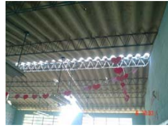
Figura No. 29 Techos de aula rotos y en mal estado
