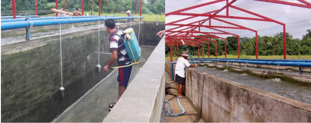
Anexo. No. 3 Mantenimiento de piletas, desinfección y sifoneos.
