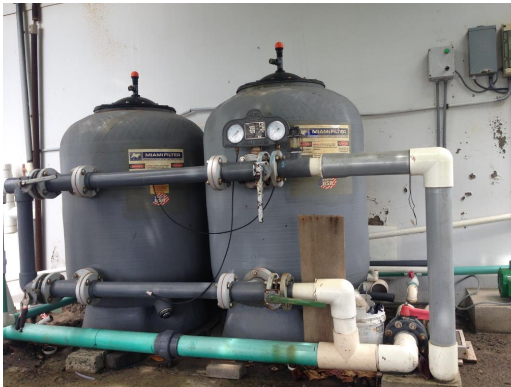
Figura N°5: Filtros de arena.
