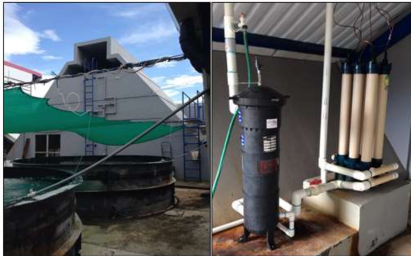
Figura 6 Pirámide distribuidora de agua y sistema de esterilizado del agua
