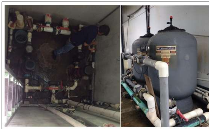
Figura 4 Sistema de bombeo y filtrado del agua marina
