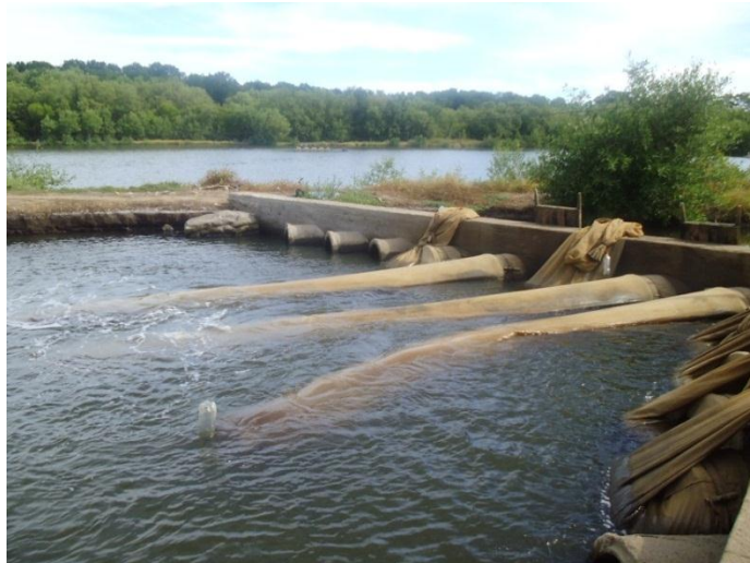
Figura No.19 Filtros bombeo 1.
