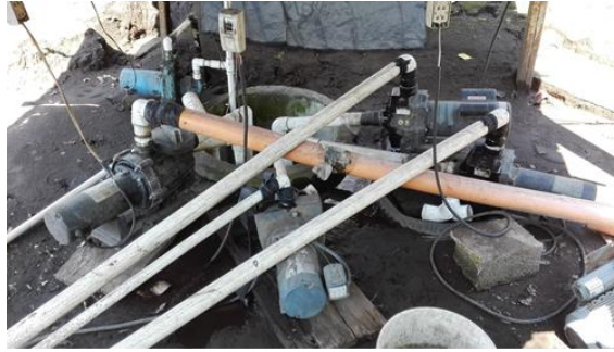
Figura No.13: Sistema de bombeo de agua de del Vivero de Isaías Gonzales
