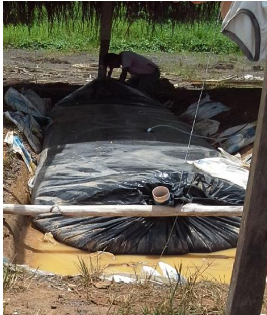
Figura No. 11. Tubo de salida de 4” de un digestor (Trabajo de campo, 2015)
