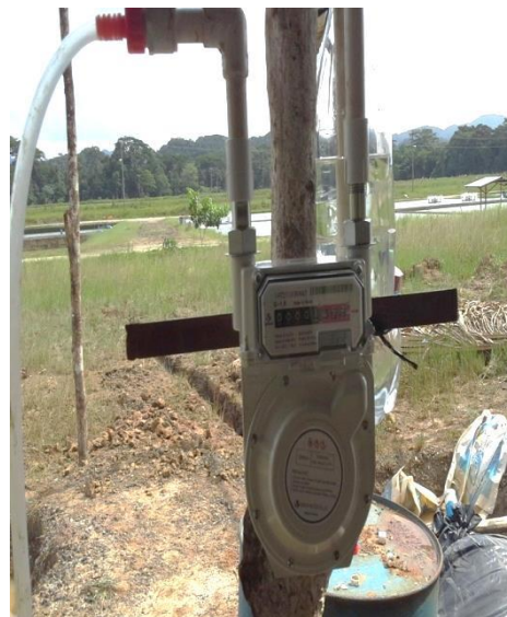
Figura No. 13. Contador mecánico de biogás (Trabajo de campo, 2015)
