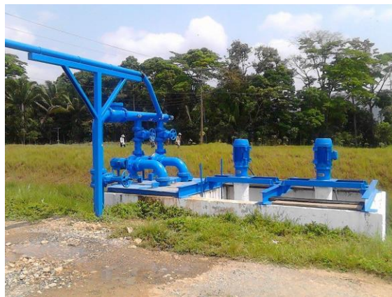
Figura No. 9 Bomba de abastecimiento de agua
