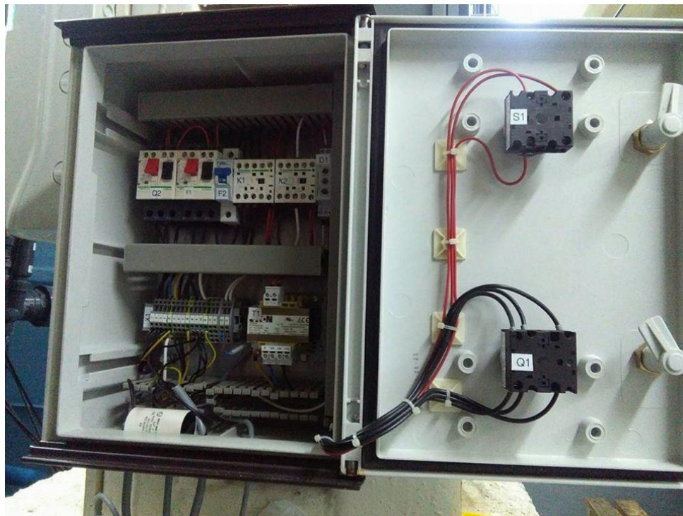
Anexo 4- Panel eléctrico del sistema de recirculación
