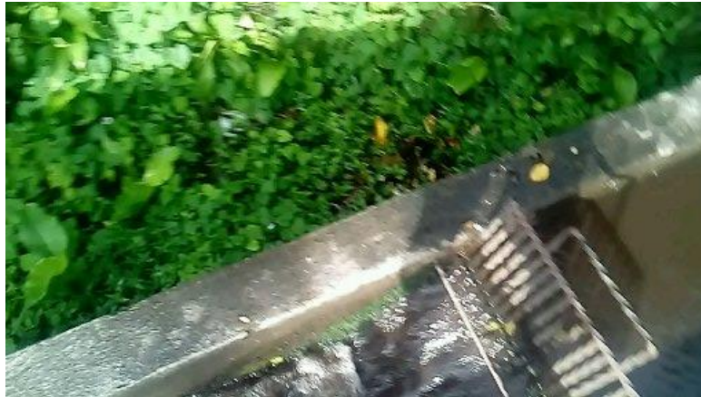
Figura 5. Rejilla captora de material suspendido
