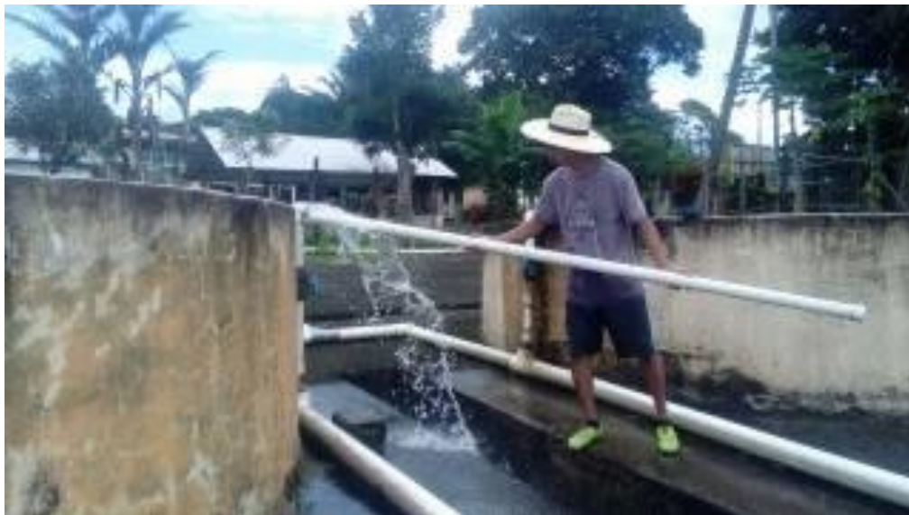
Figura 4. Limpieza de Flautas, Candelas y Camisas.
