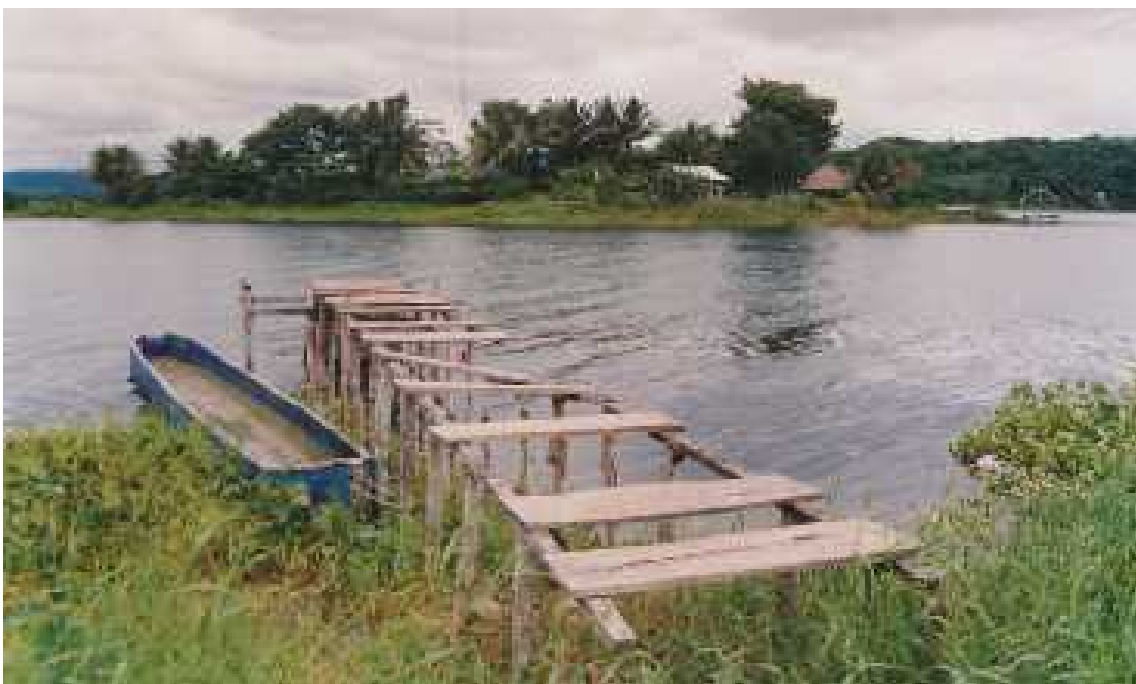
Litoral del lago, alguna mínima infraestructura que ha habido, se ha deteriorado.
