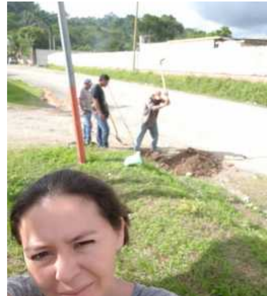
Búsqueda de la tubería para reinstalar el servicio de agua a INEB. Miguel Ángel Asturias. Elaborada por epesista
