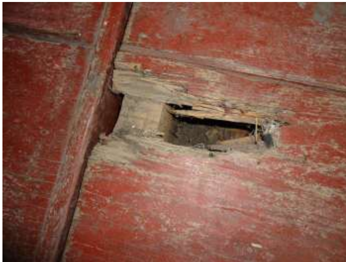
Fotografía No.14. Tarimas en mal estado
