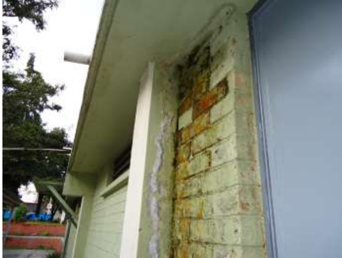
Fotografía No.1: Falta de mantenimiento de edificios Módulo de vigilancia EFPEM/USAC
