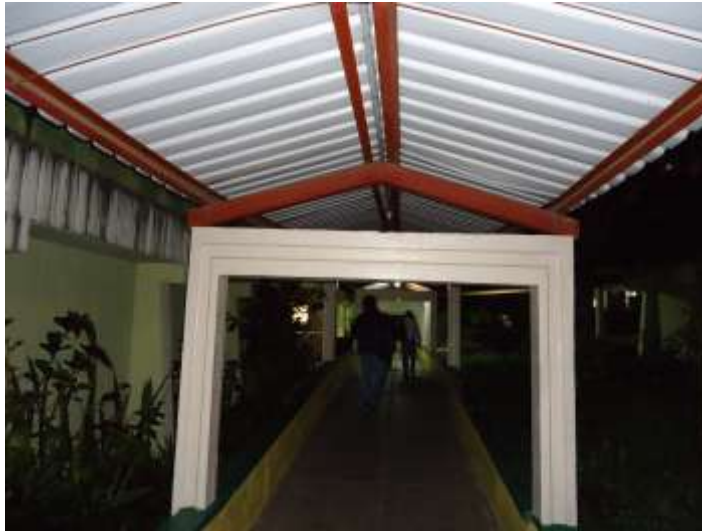
Fotografía No.16. Pasillos sin iluminación eléctrica Ponen en riesgo a la comunidad educativa Exterior Módulo "C" EFPEM/USAC
