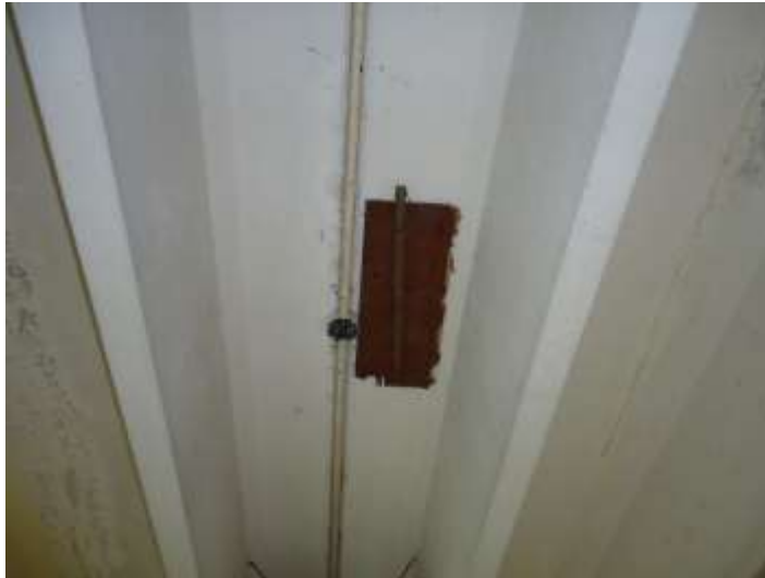
Fotografía No. 13. Reparaciones improvisadas para evitar goteras
