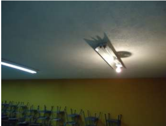
Fotografía No. 12. Una Plafonera improvisada que sustituye a una Lámpara de Gas Neón Faltante y una quemada Ponen en riesgo a la comunidad educativa Módulo "N" EFPEM/USAC
