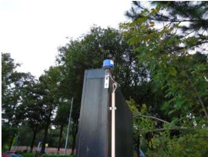
Fotografía No.4. Cables sueltos sin tubería puede causar corto circuito eléctrico Parqueo administrativo EFPEM/USAC
