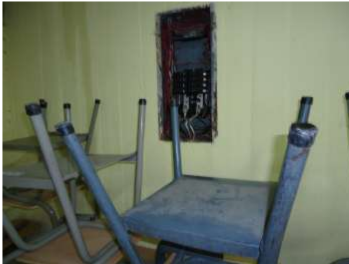
Fotografía No.15. Caja de Flipones sin protección y obstruida
