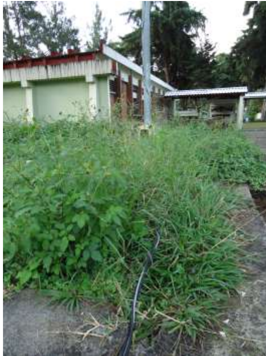
Fotografía No.5. Cables sueltos sin tubería puede causar corto circuito eléctrico A un costado del auditorium EFPEM/USAC
