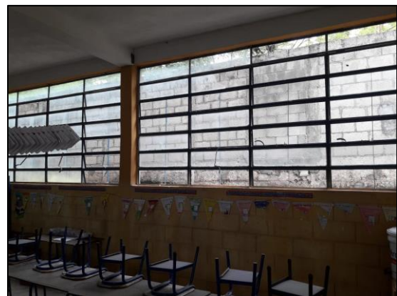
Fotografía 4: Ventanas a reforzar.
