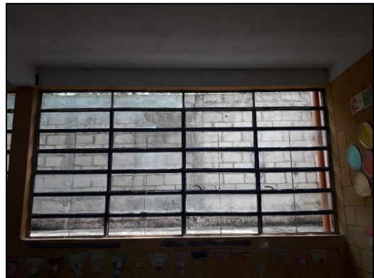
Fotografía 13: Ventanas donde es necesaria la mejora.
