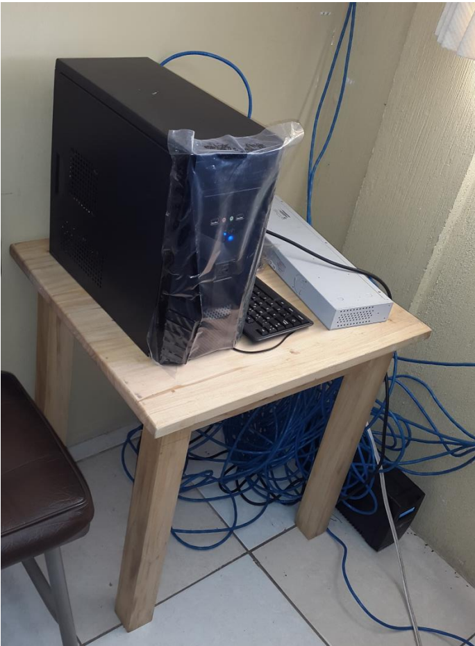
Servidor instalado en tesorería del Centro Universitario.
