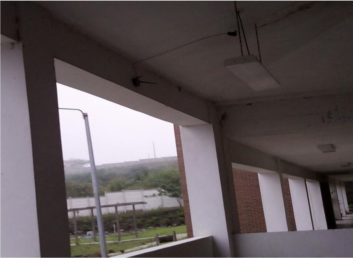
Routers instalados en pasillos del edificio universitario.
