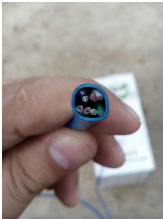
Después del proyecto la instalación quedó así:
