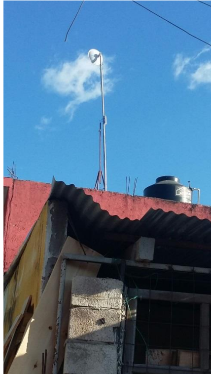
Antena instalada en el casco urbano de Cuilapa.
