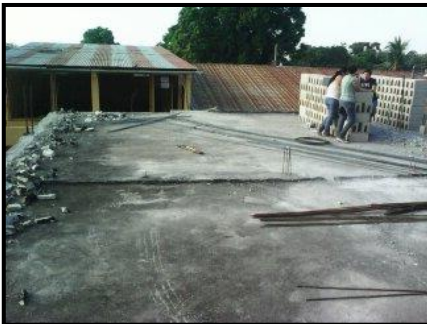
Fotografía número 12: Antes, terraza del Instituto Mixto de Educación Diversificada por cooperativa, área para construcción.
