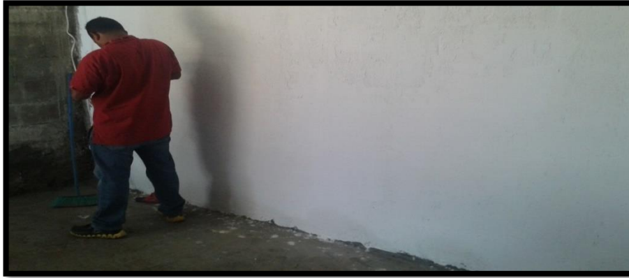
Foto No.07/parte interior del local a futuro para el uso de la biblioteca
