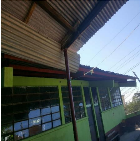
Figura 10: estado de la escuela antes del voluntariado
