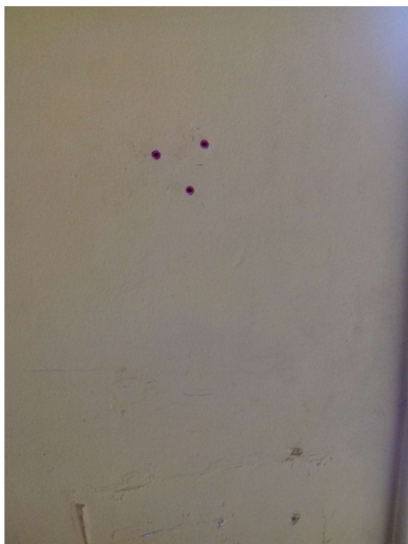
Figura No. 21 Ubicación estratégica de la instalación del extintor en la municipalidad de Cuilapa, Santa Rosa.
