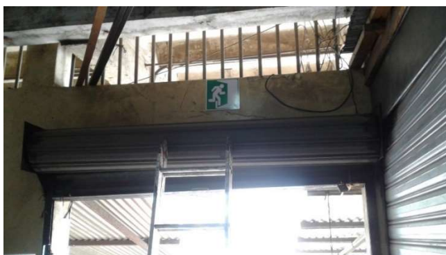
Figura No. 14 Señal instalada en salida de emergencia dentro del sótano del edificio del mercado municipal. Fuente: Fotografía tomada por el estudiante.
