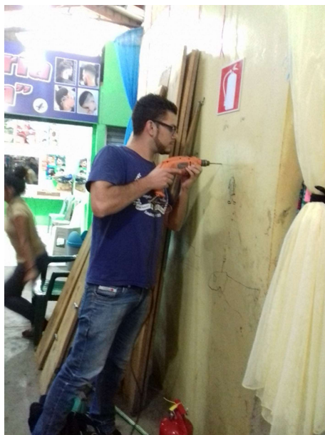
Figura No. 23 Instalación del extintor en el segundo nivel del mercado municipal. Fuente: Fotografía del personal de la municipalidad.
