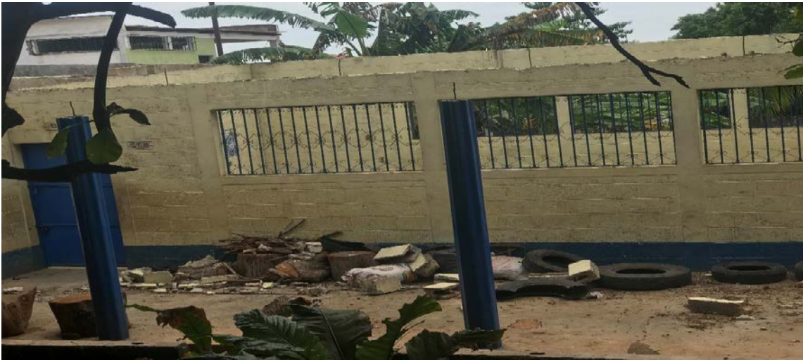
Figura No. 5 Fotografía de ejecución de proyecto, se observa el techo sin la lámina picada. Fuente: elaboración propia.
