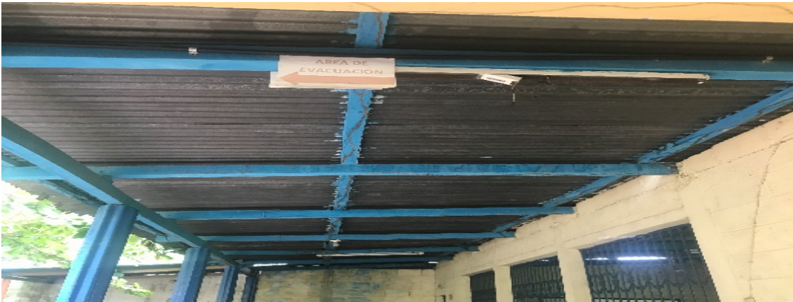
Figura No . 3 Imagen del techo del aula de sexto primaria sección C. Fuente: Elaboración propia.
