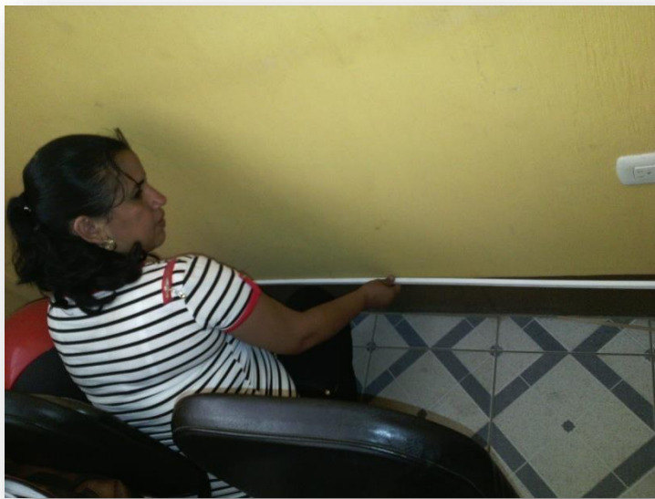
Figura 25. Estudiante del Ejercicio Profesional Supervisado instalando regleta, para cable que conecta señal de internet a las computadoras.
