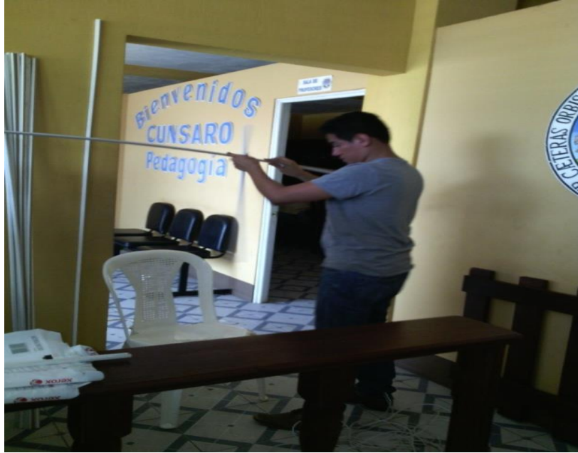
Figura 26. Técnico en computación haciendo la instalación para conectar internet a las computadoras donadas en el proyecto.
