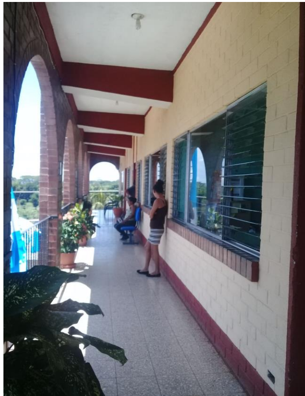
Fotografía 2 Inexistencia de nomenclatura del edificio municipal
