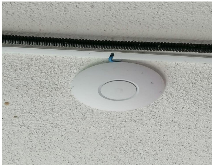
Fotografía No. 70 Router Ubiquiti UAP-AC-lite instalado. Fuente: Mariela Molina.
