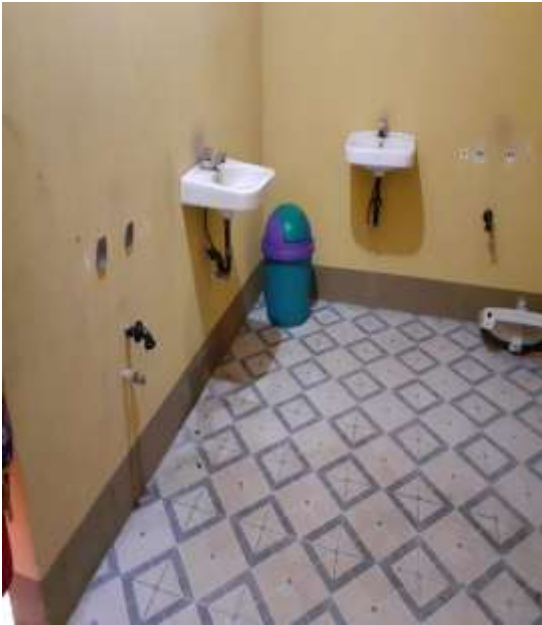
Figura 4. Estado inicial de los lavamanos
