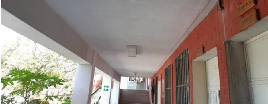
Fotografía 10 /No se cuenta con un cableado de red telefónica
