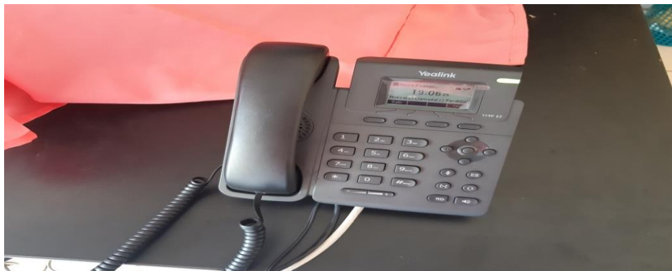
Fotografía No. 12 Teléfono inalámbrico instalado
