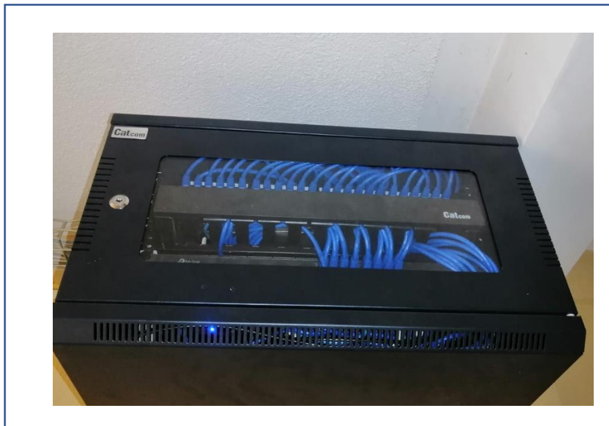
Fotografía No. 3 Caja para cableado de teléfono. Fuente propia
