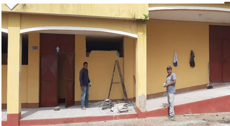
Figura 15 Rotura de ventana en los sanitarios de mujeres.
