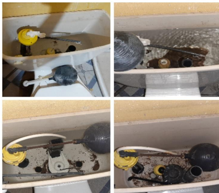
Figura 29 Tanques de agua de los sanitarios de mujeres.
