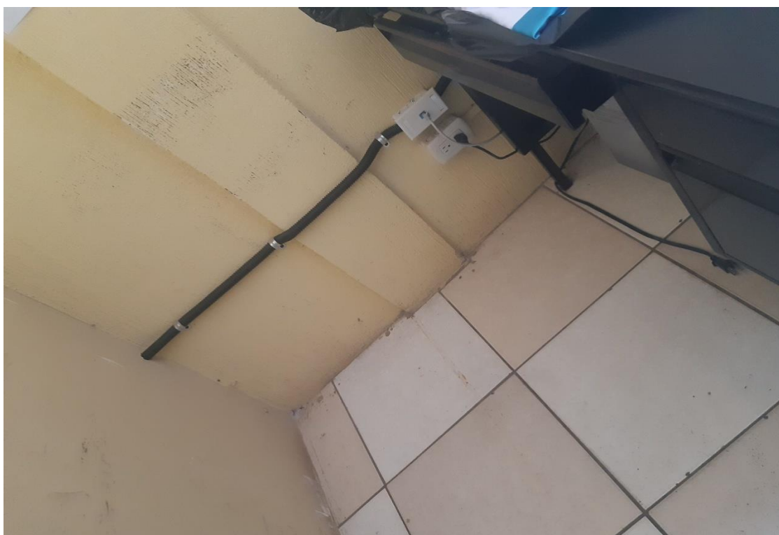
Fotografía 13 /Cableado instalado/Fuente: Shirley Zepeda
