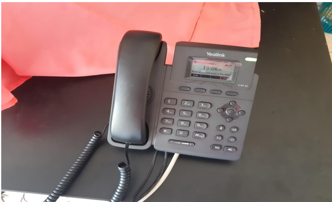
Fotografía 12 /Teléfono Alámbrico instalado/Fuente: Shirley Zepeda
