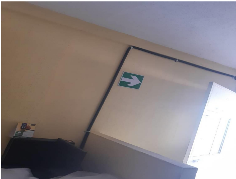
Fotografía 15 /Cableado instalado/Fuente: Shirley Zepeda Marroquín
