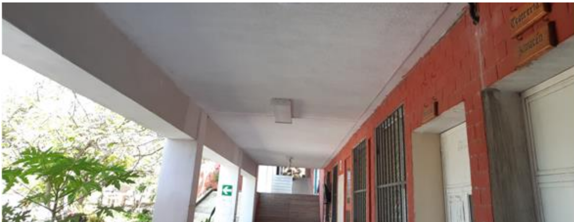
Fotografía 8 /No se cuenta con un cableado de red telefónica Fuente: Shirley Zepeda
