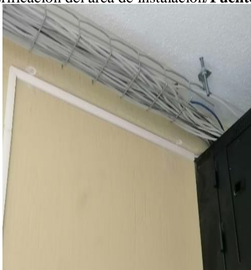
Fotografía No. 62/Verificación de cables UTP existentes/Fuente: Cristian Véliz.
