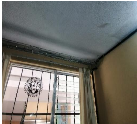
Fotografía No. 61/Verificación del área de instalación/Fuente: Cristian Véliz.
