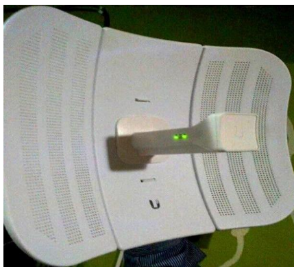
Fotografía No. 65 /Antena Ubiquiti para telefonía instalada/ Fuente: Marvin Ramos Barrientos.
