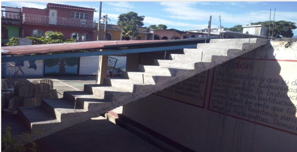
Figura 11. La fotografía muestra la construcción de gradas del primer nivel al segundo nivel del edificio del instituto IMEDCO.
