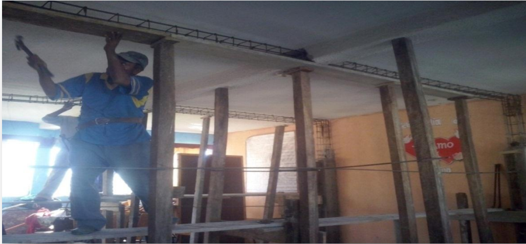
Figura 10. La fotografía muestra el reforzamiento de terraza del primer nivel del edificio del instituto IMEDCO.
