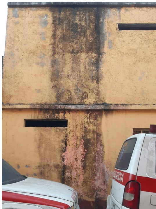
Fotografía 3. Pared dañada por humedad
