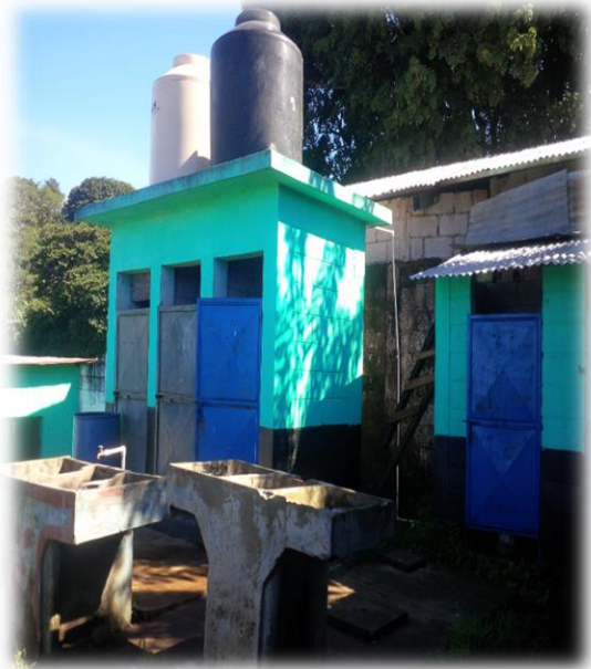
Fotografía 27/Deterioro de pintura en sanitarios
