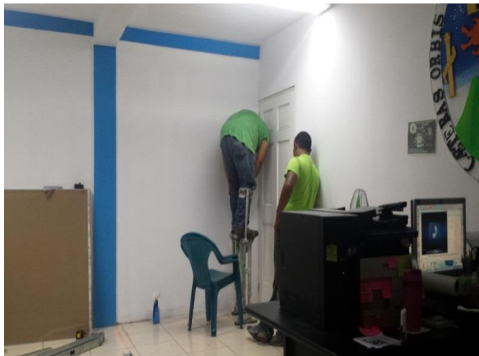
Foto 2: Construcción del módulo con mobiliario y equipo tecnológico, para uso de la coordinación de la carrera de Pedagogía, sección Cuilapa.
