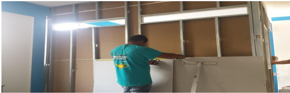
Foto 4: Construcción del módulo con mobiliario y equipo tecnológico, para uso de la coordinación de la carrera de Pedagogía, sección Cuilapa.
