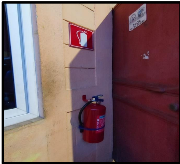
Ilustración 11 Cabina Telefónica, Extintor
