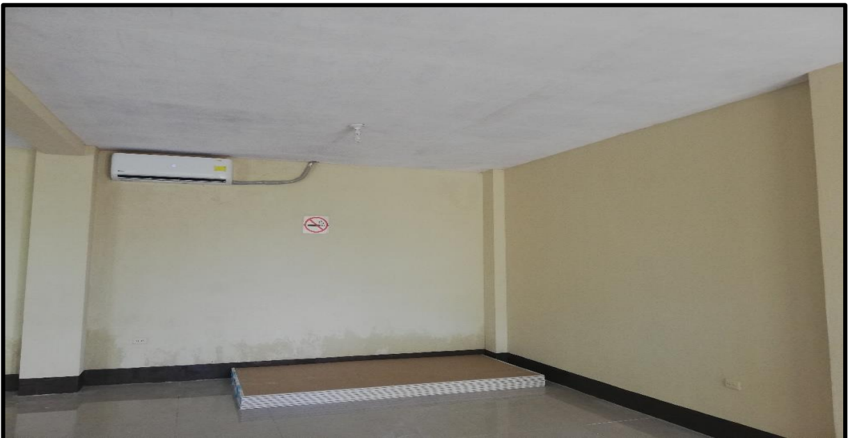
Fotografía 15 Instalaciones de Aire Acondicionado terminado del Salón de Usos Múltiples de CUNSARO Chiquimulilla.
