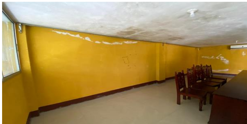
Figura 21 Vista de las paredes dañadas del escenario del salón mayor
