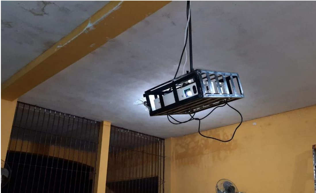
Figura 16 Instalación de videoproyectores
