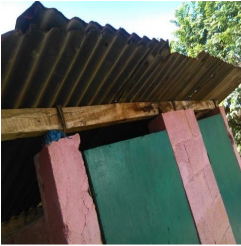
Figura No.3. Instalaciones de sanitarios en mal estado.
