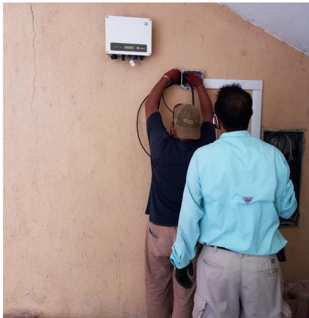
Fotografía 20. Funcionamiento adecuado de las celdas fotovoltaicas en el centro Universitario de Santa Rosa.
