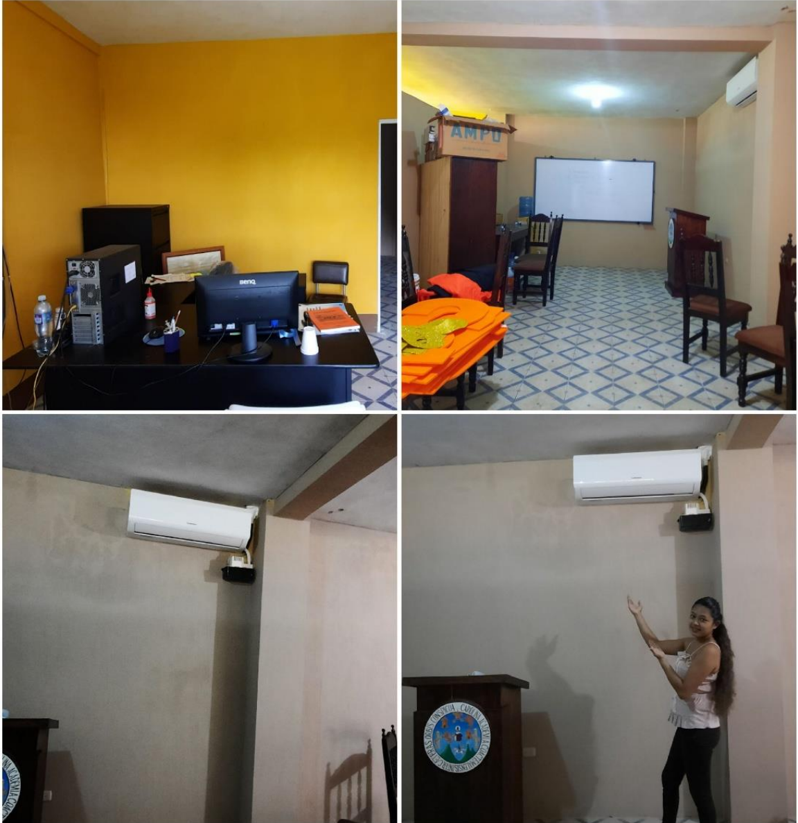
Figura 6. Sistema de aire acondicionado instalado.
