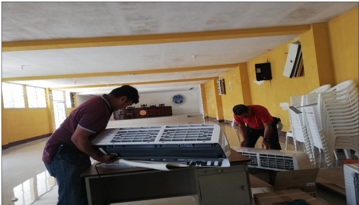
Fotografía 12 Instalación de aires acondicionado del salón de usos múltiples de CUNSARO Chiquimulilla.
