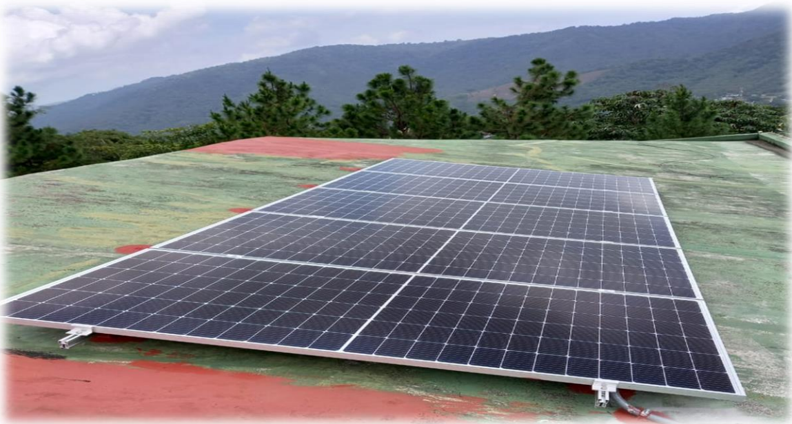
Fotografía No. 21. Paneles solares instalados, proyecto finalizado /Fuente: Saira Sucely Hernández Ramírez, estudiante Ejecutora
