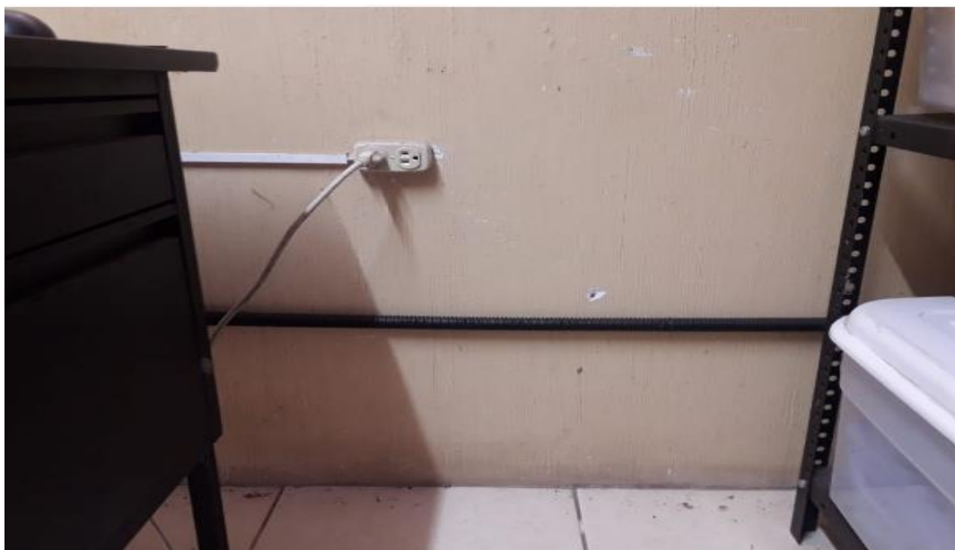
Fotografía 15. Cableado telefónico instalado
