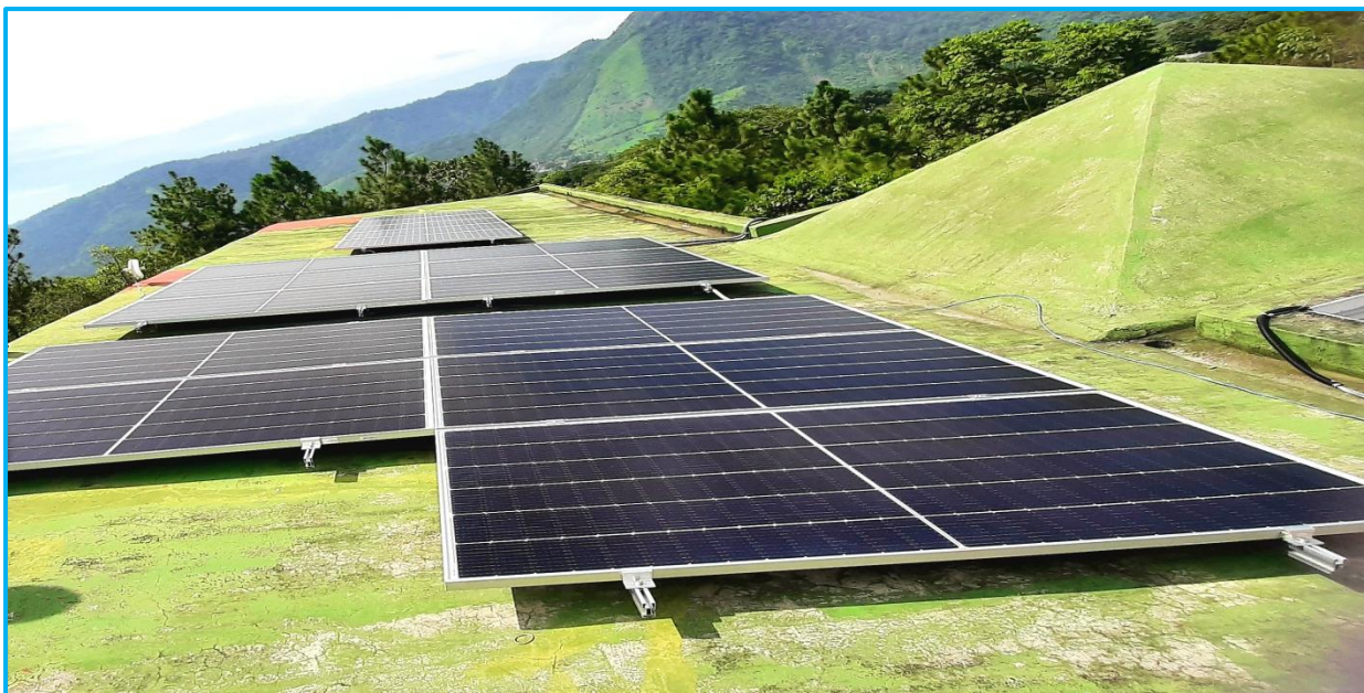
Fotografía No. 29. Paneles solares instalados.
