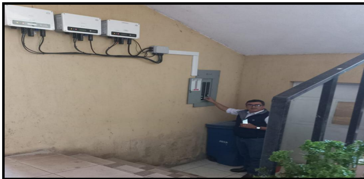
Fotografía No 31. Verificación de la instalación por parte del profesional especializado en la instalación de paneles solares.
