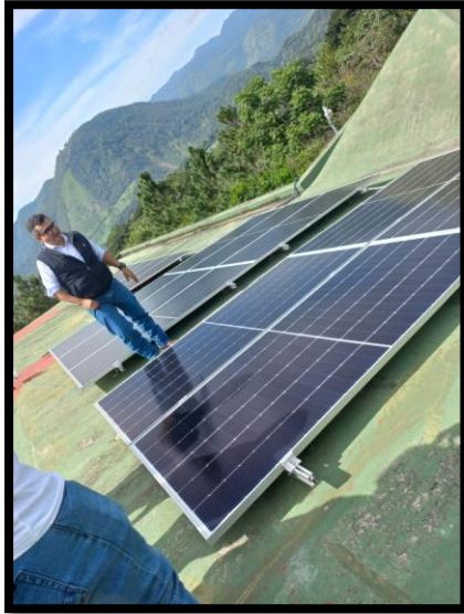
Fotografía No 27. Paneles instalados en el Centro Universitario de Santa Rosa.
