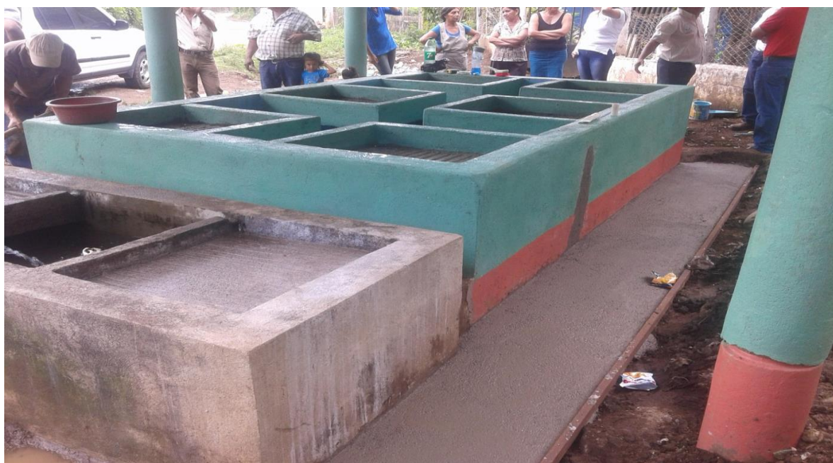
Figura 12. Vista de los seis lavaderos y banqueta a un costado del proyecto. (después)
