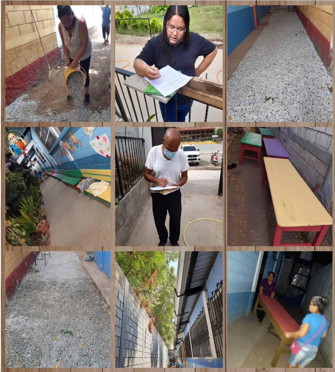
Figura 32 Inicio de trabajo para habilitar el comedor escolar en la escuela Oficial de Párvulos anexa a Escuela Oficial Urbana Mixta, colonia Nueva Vida, municipio de Guastatoya, departamento de El Progreso.
